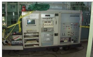
高圧電動機絶縁診断
